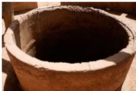
Att hämta vatten kan vara farligt för barnen eftersom de gamla brunnarna är djupa och saknar skyddande galler.
